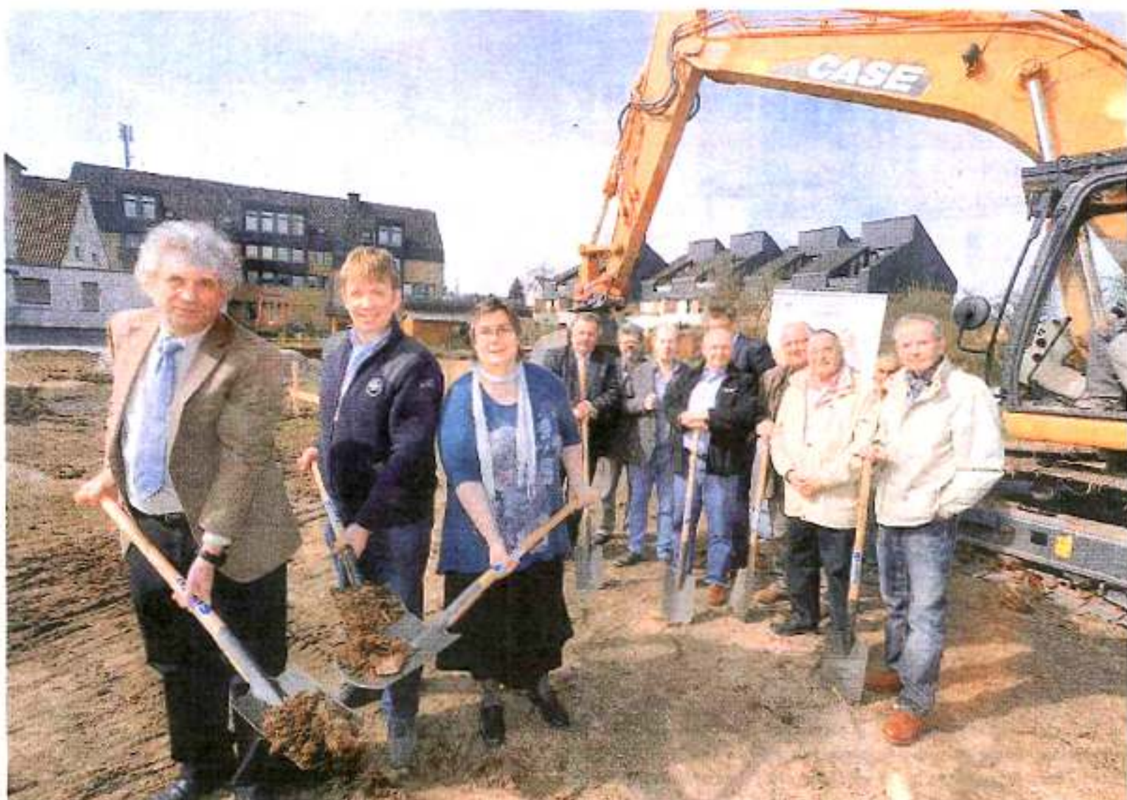
Nehmen Erde auf die Schippe: Holm Sternbacher, Klaus Sieweke und Kerstin Bergner (vorne v.l.) beim ersten symbolischen Spatenstich am Hassebrock, dahinter (v.l.) Andreas Rüter, Harald Daube, Michael Beimdiek, Ralf Großegödinghaus, Gunnar Maedel (verdeckt), Horst Sieweke, Kurt Stuke und Jörg-Rüdiger Schütz.
