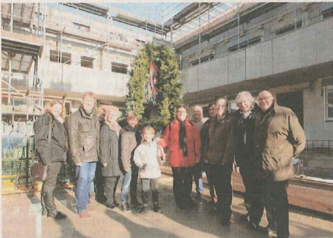
Alles im Plan: Bauherren, Politiker, Planer und Arbeiter feierten gestern Richtfest am Hassebrock in Heepen. FOTO: WOLFGANG RUDOLF
